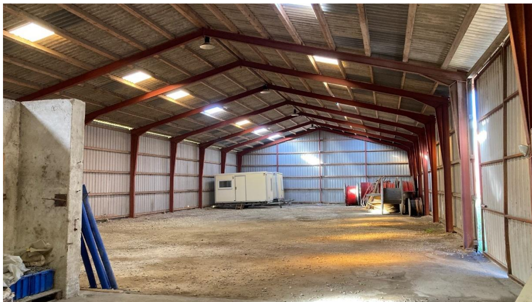
Figur 5 Åbne haller uden hulrum i tagkonstruktionen rummer ikke sandsynlige rastesteder for flagermus.
