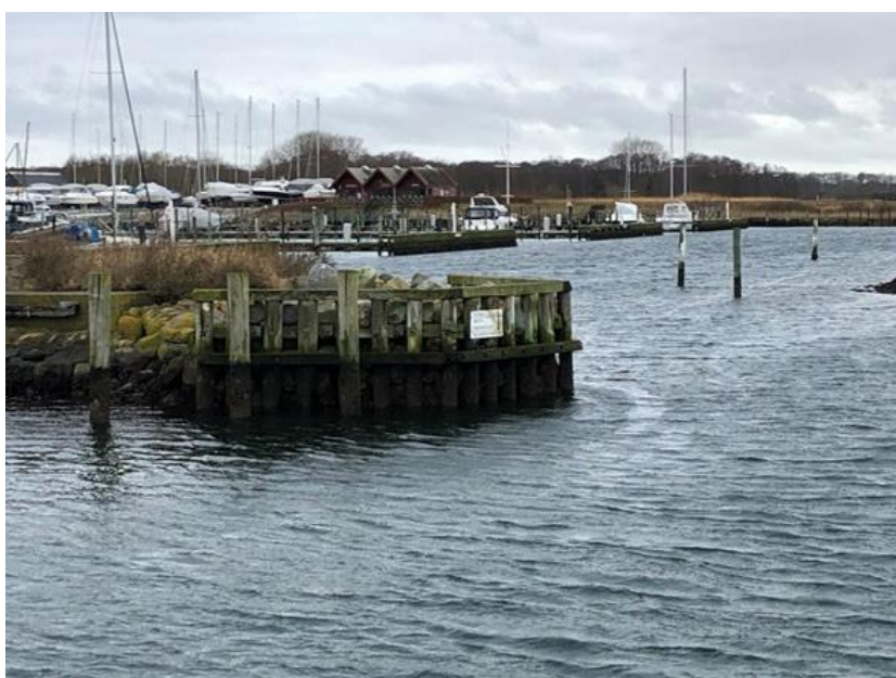
Figur 3 – Molehoved med begrænset restlevetid langs vestlig side af indsejlingen til Årø Sund Havn
