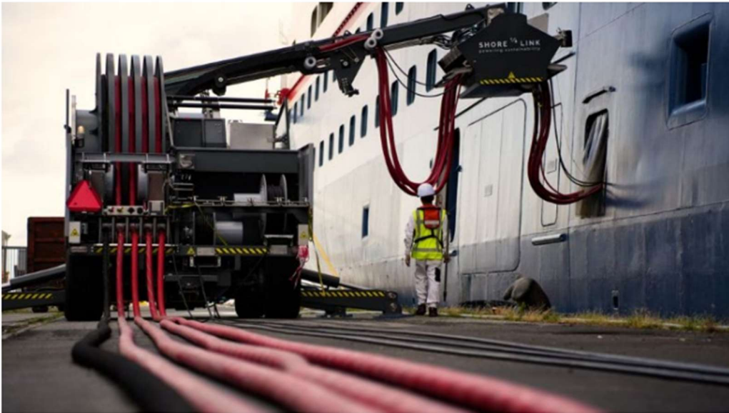
Figur 2: Koblingspunkt mellem landsstrømanlæg og krydstogtskib. Koblingspunktet er i dette tilfælde et mobilt kabelstyringssystem.
