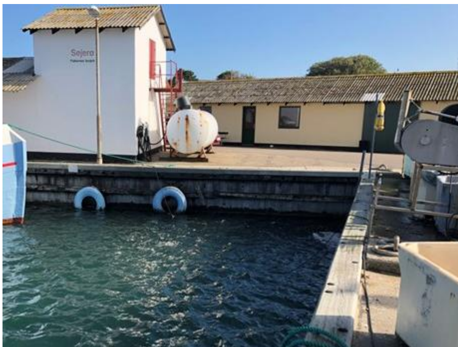
Figur 2 – Den eksist. træspuns i den gamle fiskerihavn i Sejersø havn. Trævæggen har tydelige tegn på angreb af pæleorm og begrænset restlevetid.
